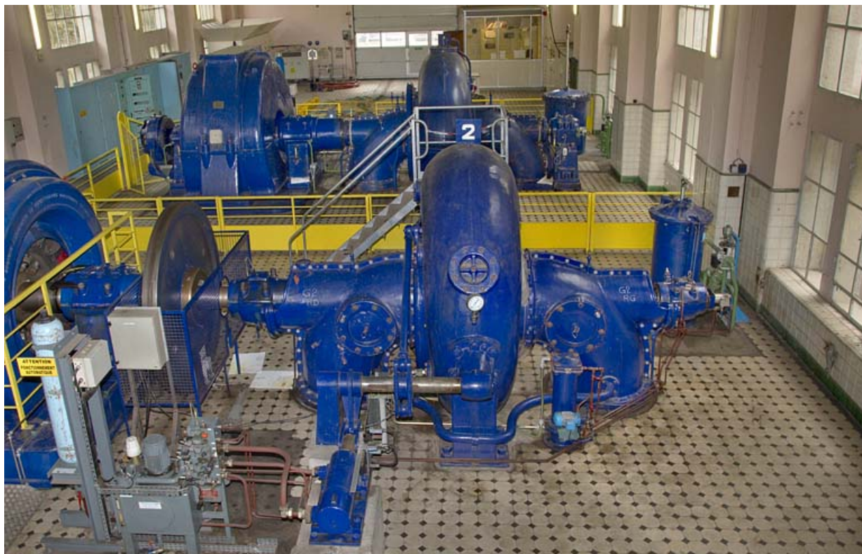
Groupe n° 2 : bache de la turbine.
