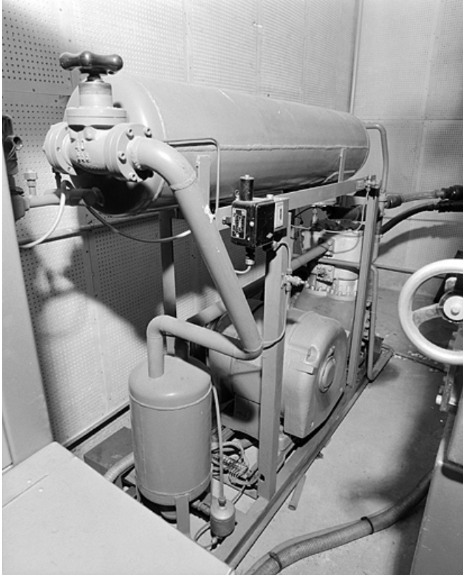
Groupe compresseur - pompe à vide.
