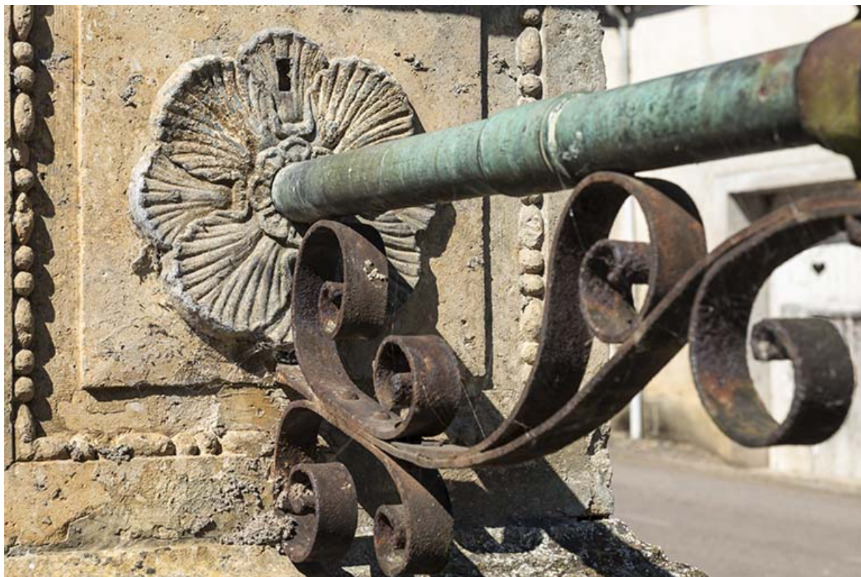
Détail du jet en fonte.
