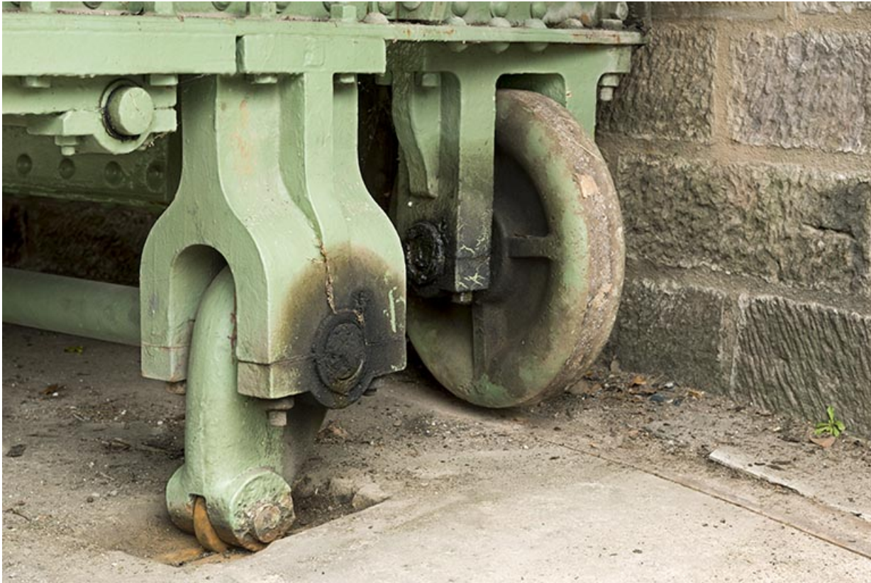
Système de calage baissé (côté amont).
