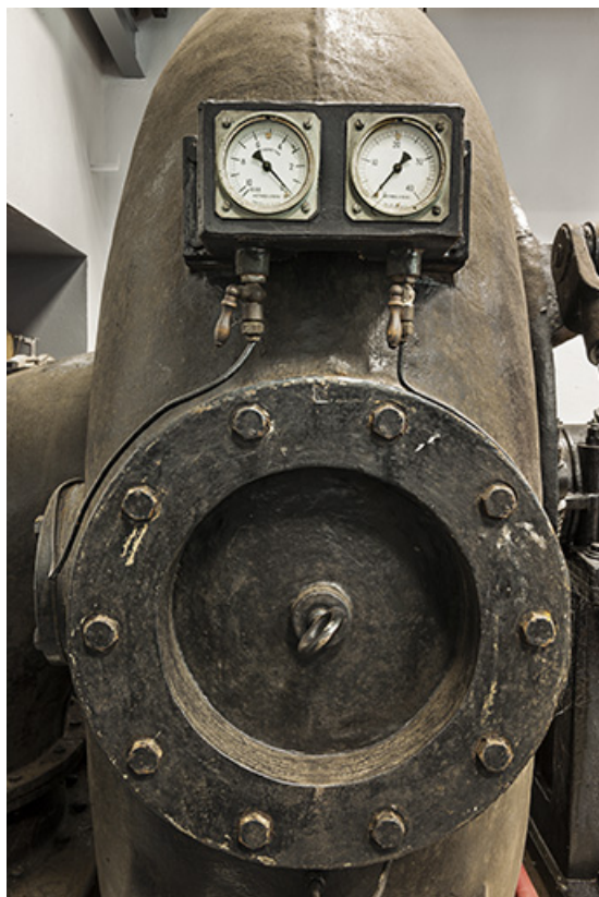
Bâche de la turbine du groupe 4.
