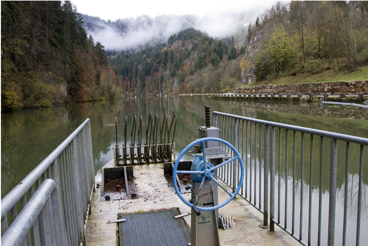
Barrage : commande de vanne de fond.
