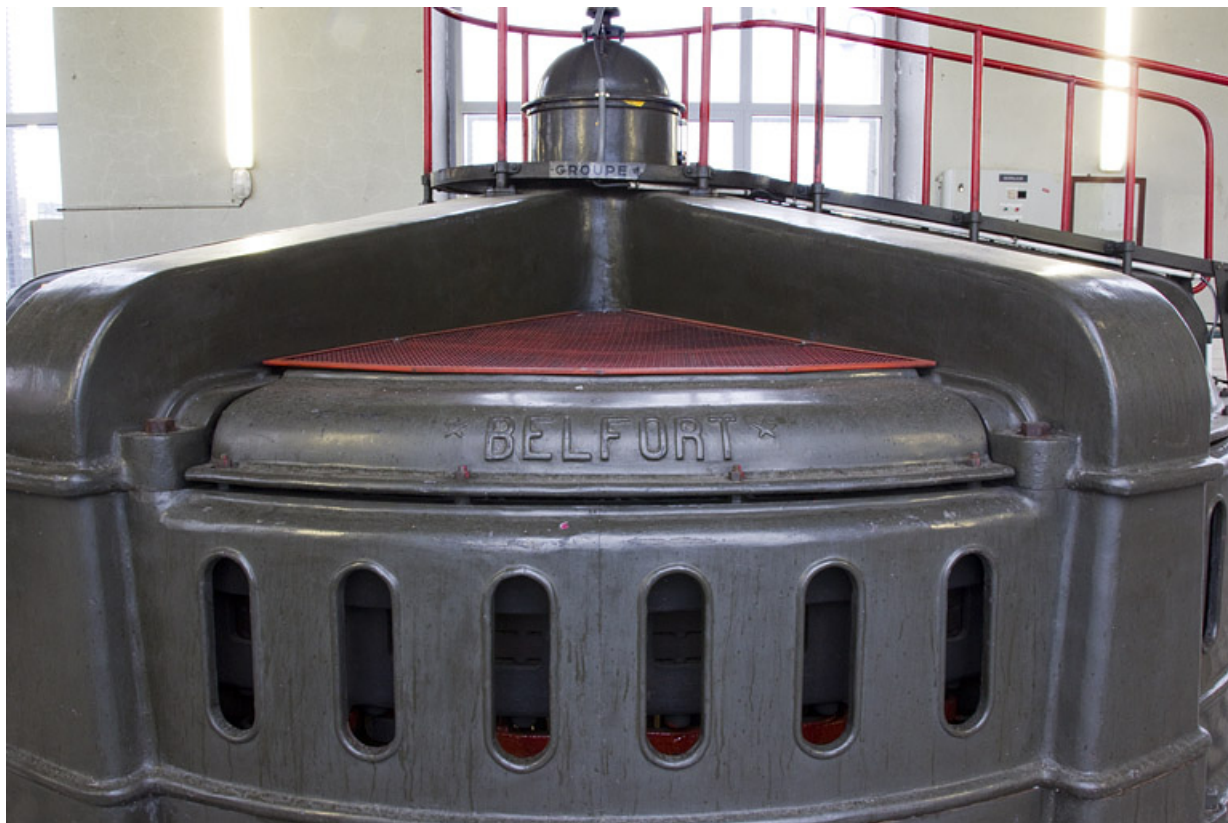
Détail d'un alternateur SACM.
