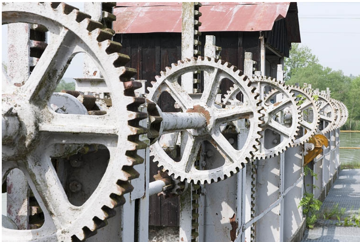
Vannage du barrage. Détail des engrenages.
