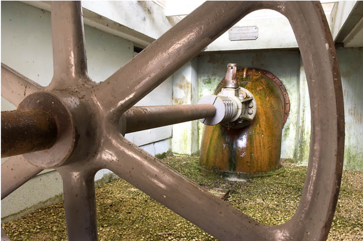
Usine : axe de transmission et volant.
