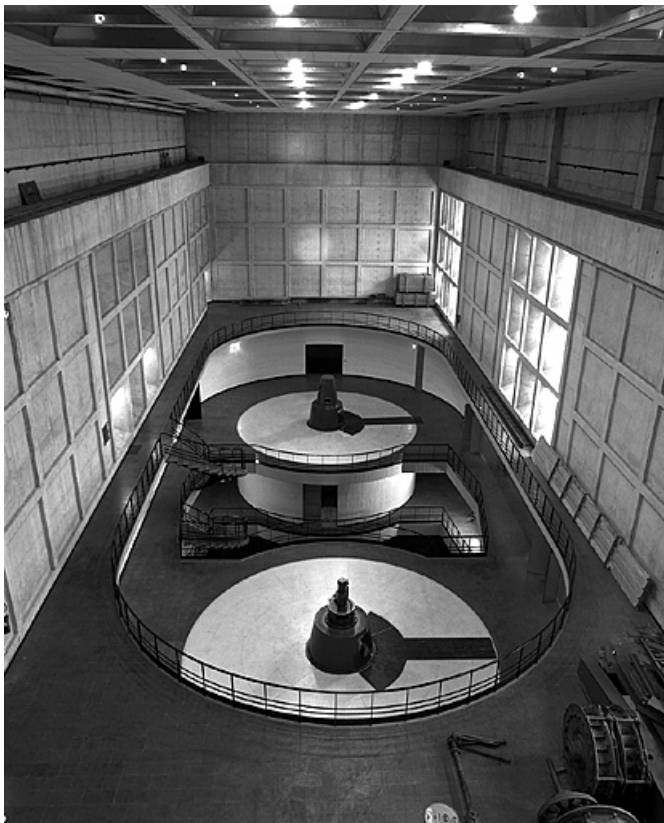
Intérieur de la centrale.
