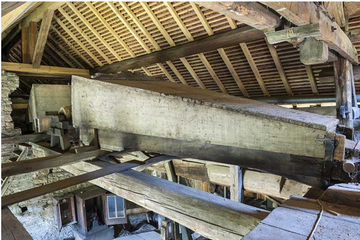
Caissons de la machine soufflante.
