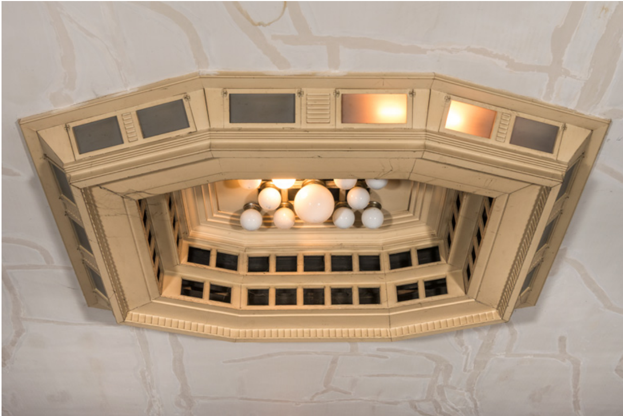
Caisson central lumineux, vu de la scène.
