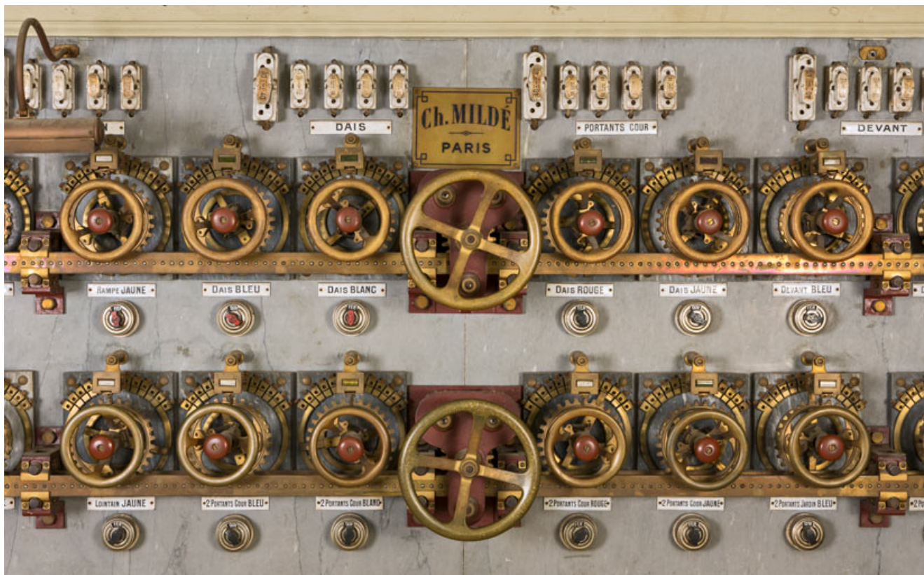
Commandes en partie supérieure : fusibles et rhéostats.
