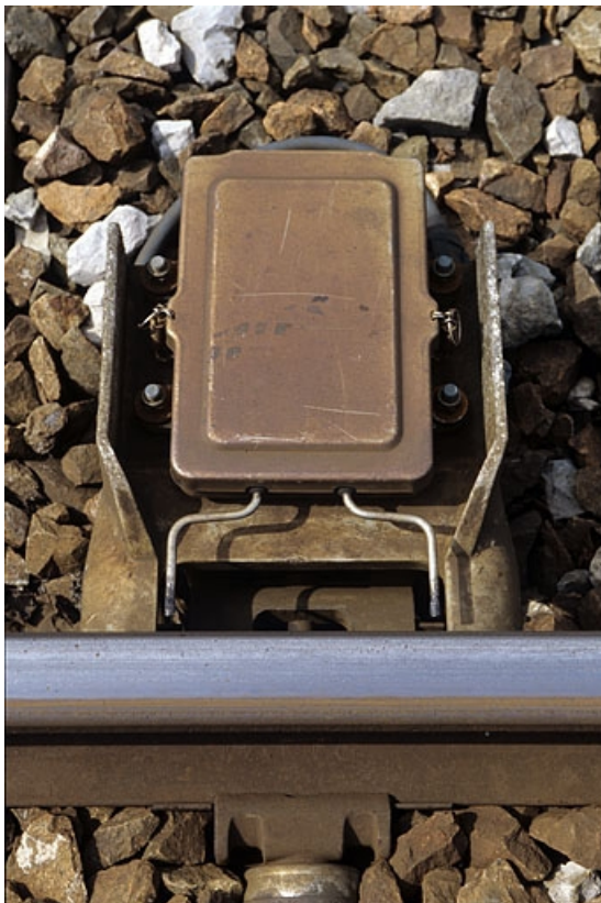
Pédale électromécanique Forflex : vue rapprochée.
