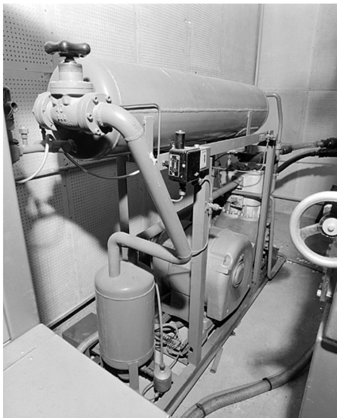
Groupe compresseur - pompe à vide.
