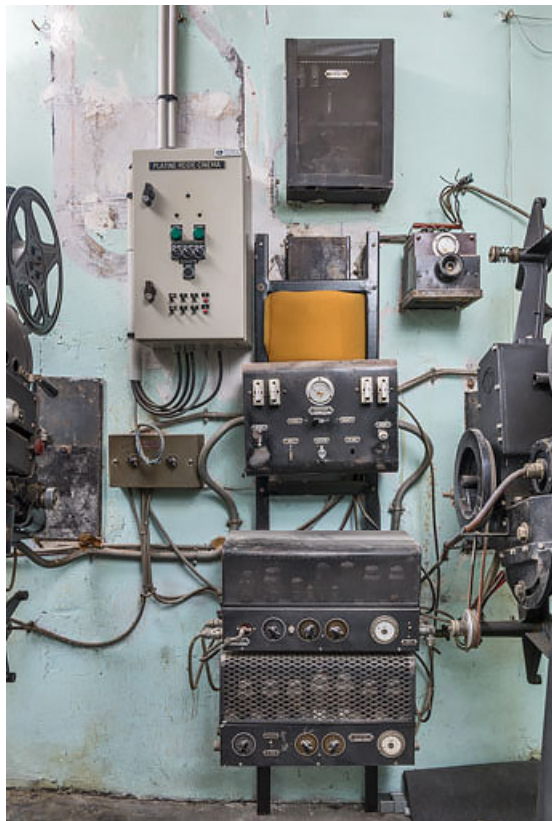
Installation de sonorisation.
