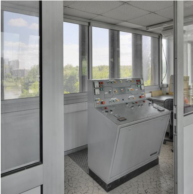
Vue intérieure de l'ancien poste de commande.
