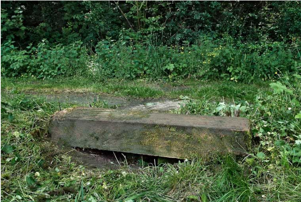
Linteau restant du pont des Freteurs.
