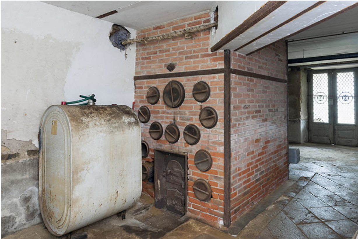
L'ancien chauffage centrale du château.
