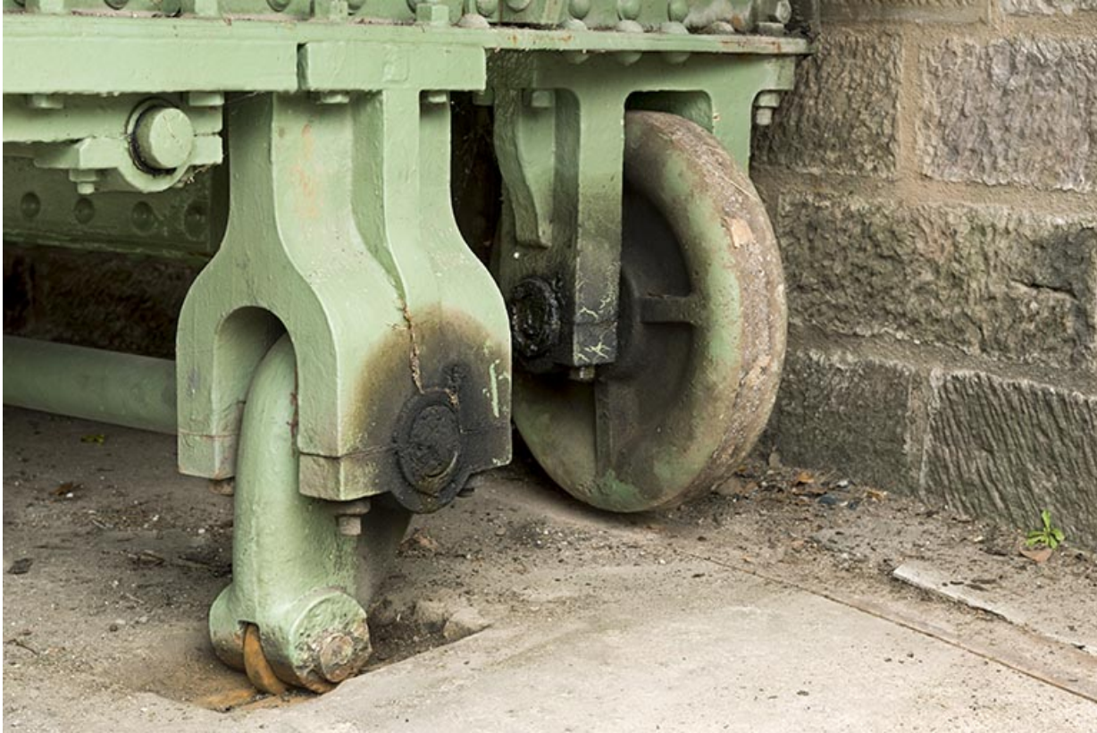
Système de calage baissé (côté amont).
