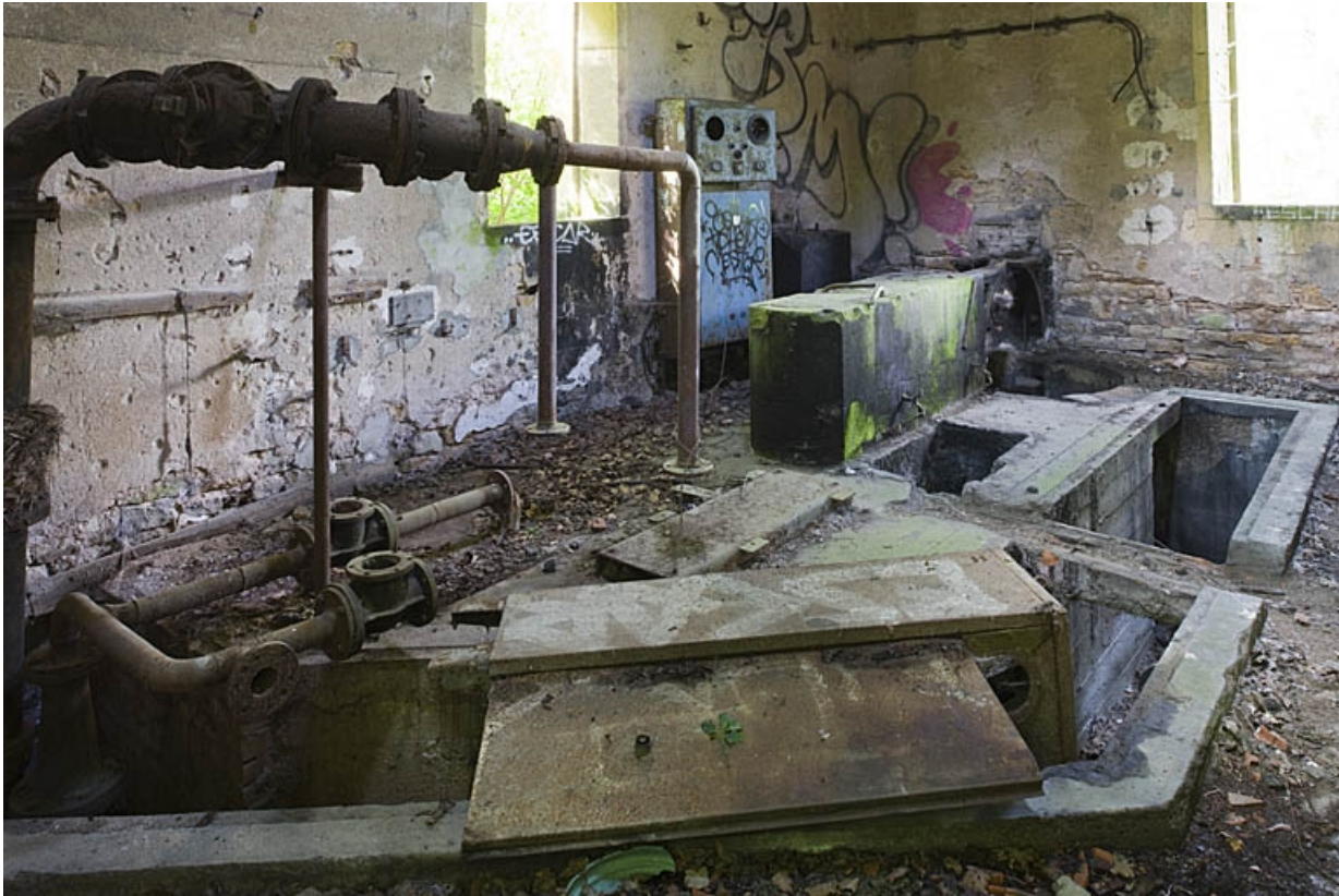
Station de pompage : vue rapprochée de l'intérieur.
