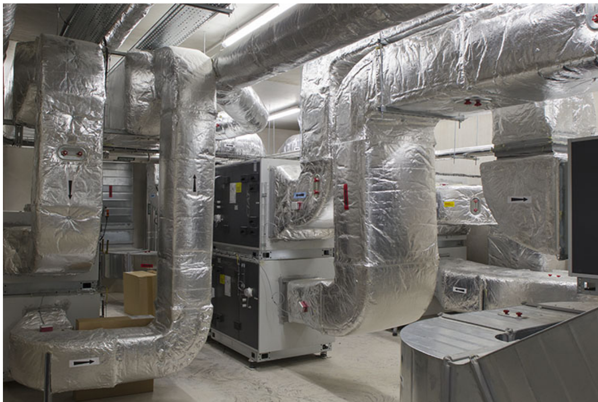
Machinerie d'extraction d'air du pôle hôtelier.
