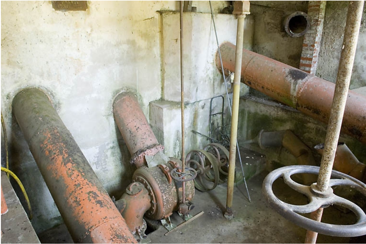
Intérieur du bâtiment d'eau.
