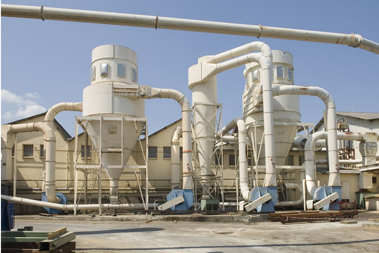
Installation de traitement de la sciure.
