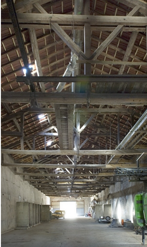
Intérieur de l'atelier de fabrication.
