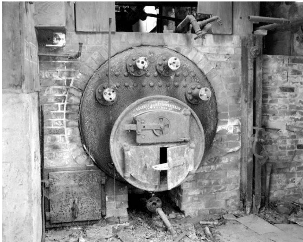
Intérieur de la chaufferie (Q) : chaudière.
