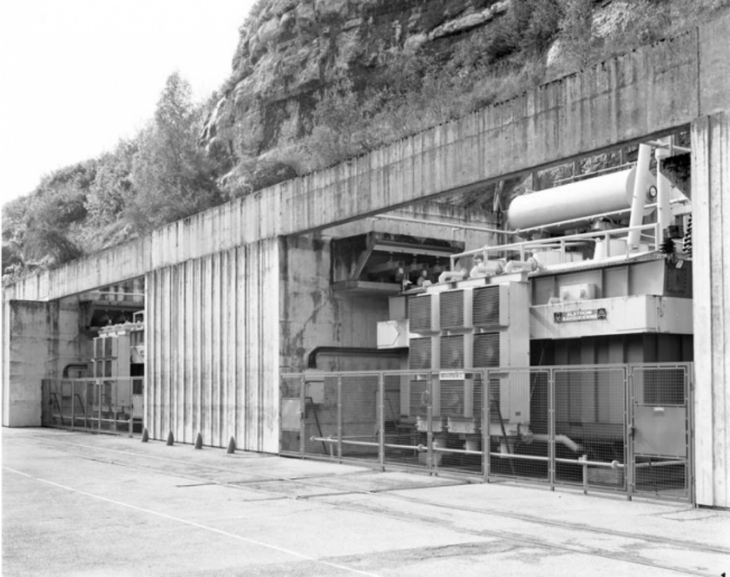
Vue d'ensemble des transformateurs.
