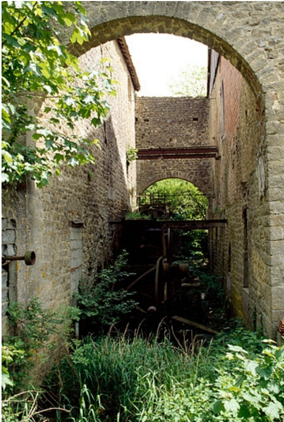
Bâtiment d'eau. Roues hydrauliques en ruine.
