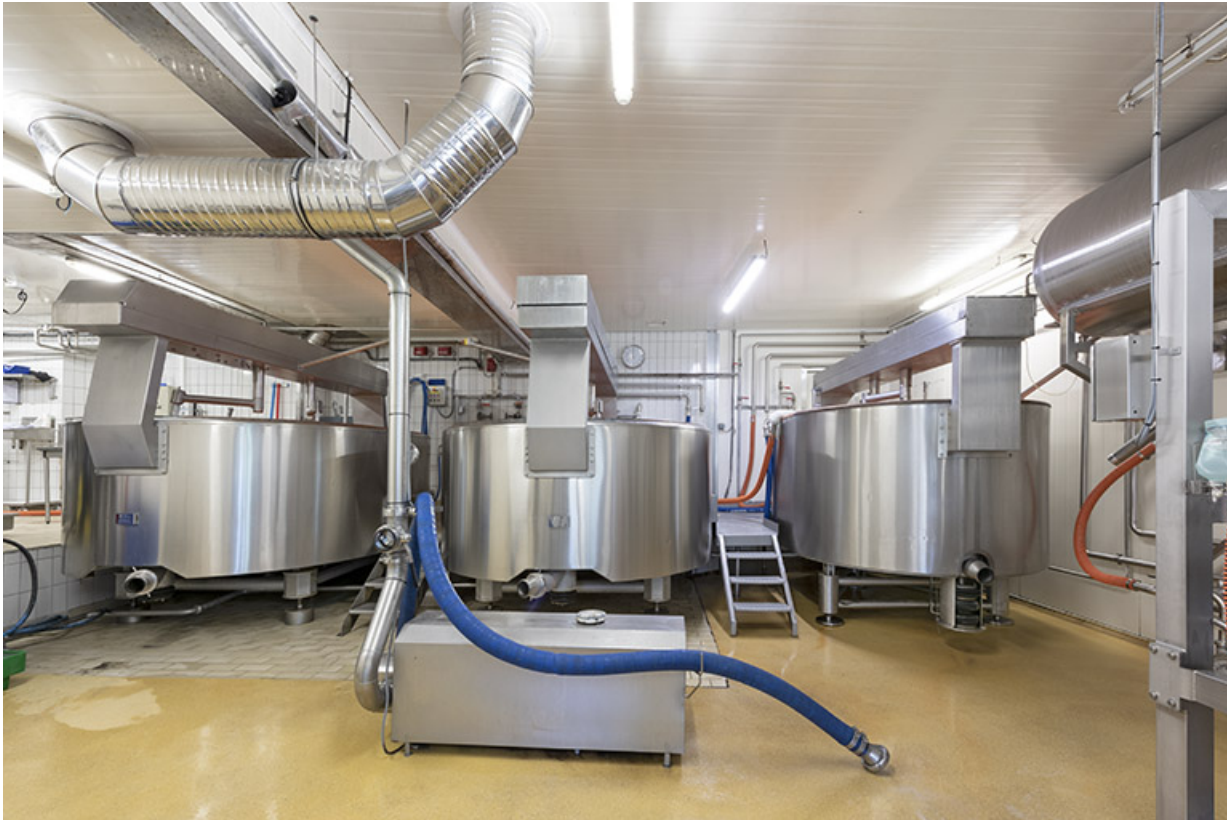
Intérieur de l'atelier de fabrication : les cuves.
