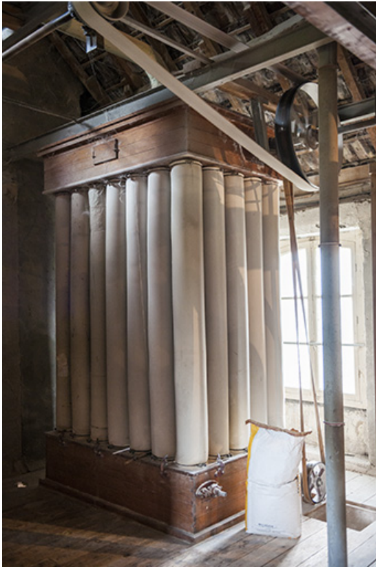
Troisième étage. Filtre à air.
