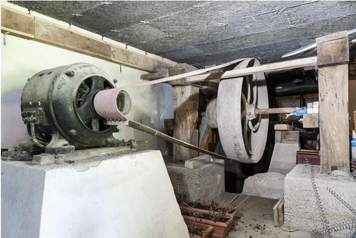
Rez-de-chaussée. Moteur auxiliaire électrique.
