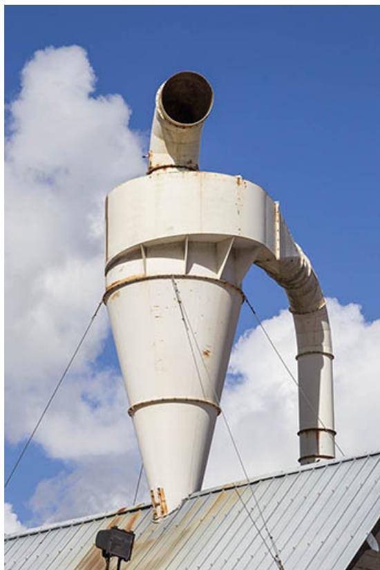
Silo à sciure (L) : cyclone.
