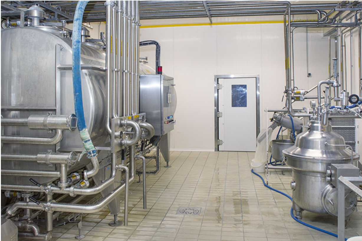
Salle de la station de lavage CIP.
