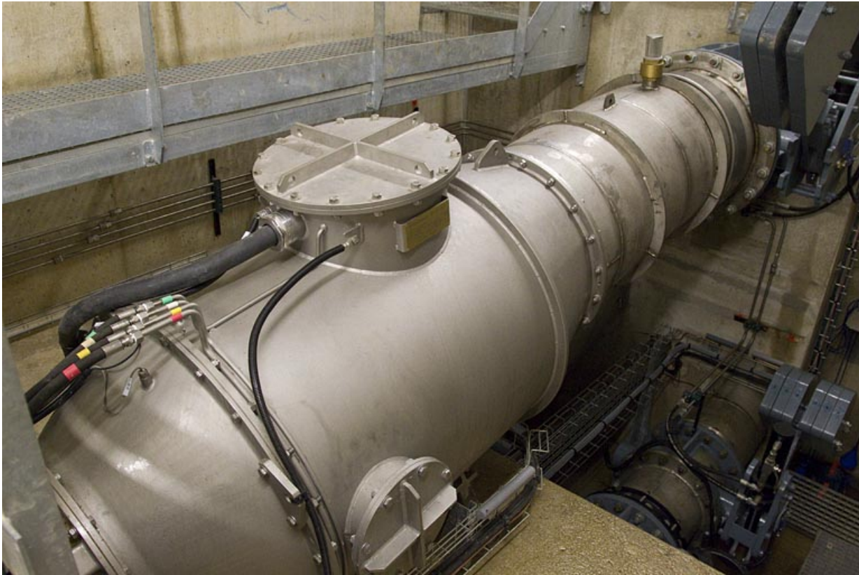
Centrale : nouveau groupe de restitution.
