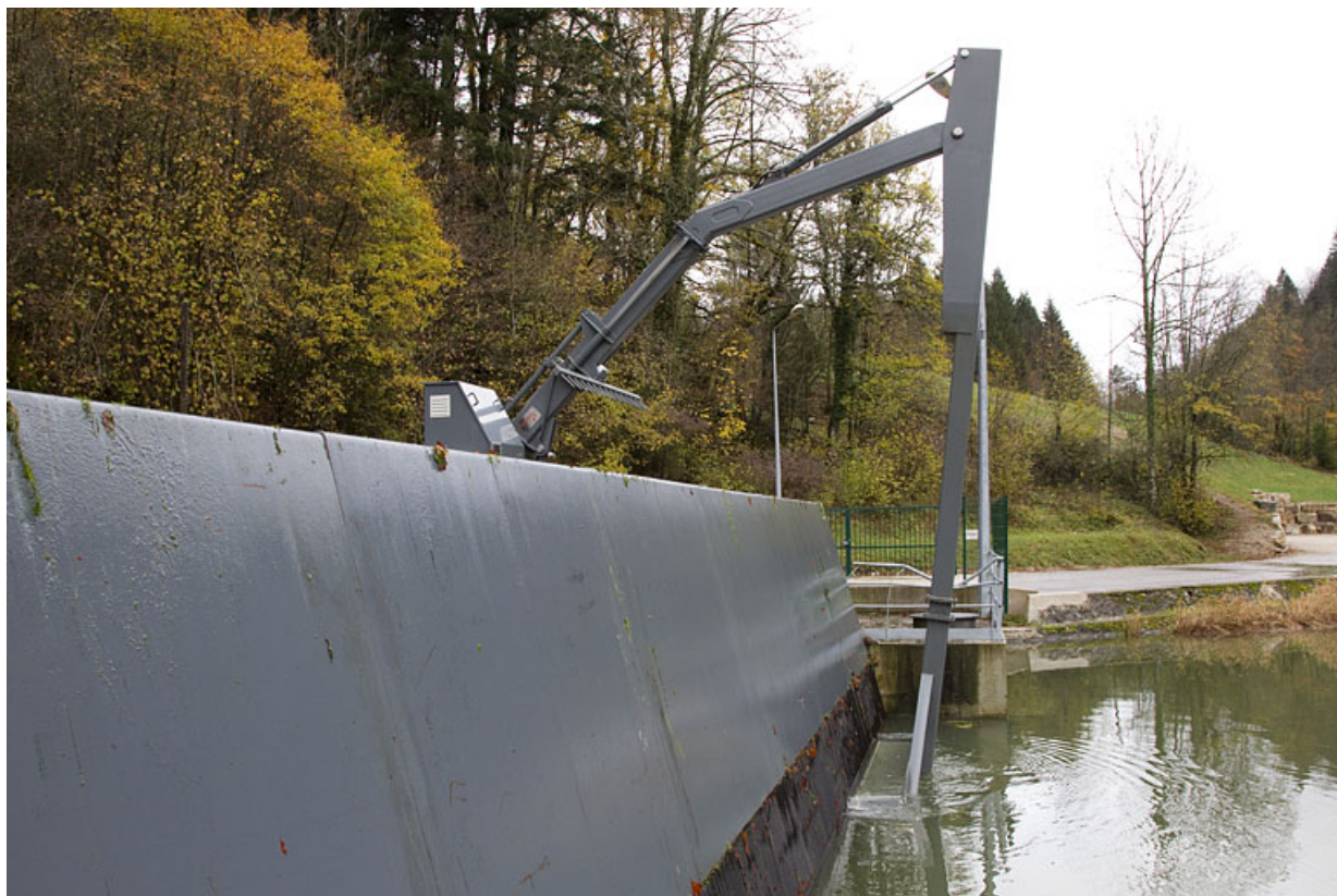
Prise d'eau : dégrilleur en fonctionnement.
