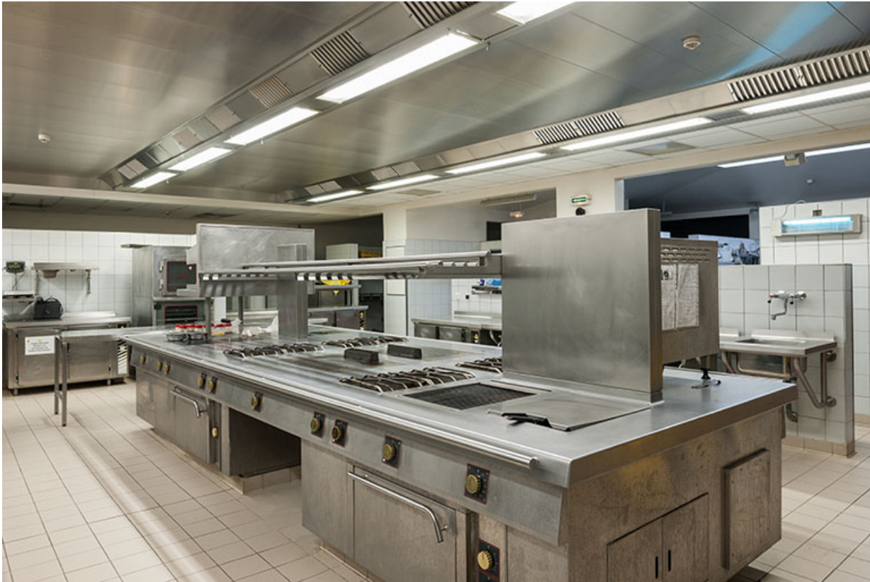
Cuisine du restaurant d'application.
