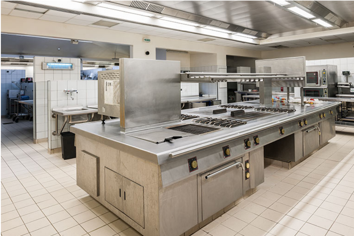
Cuisine du restaurant d'application.
