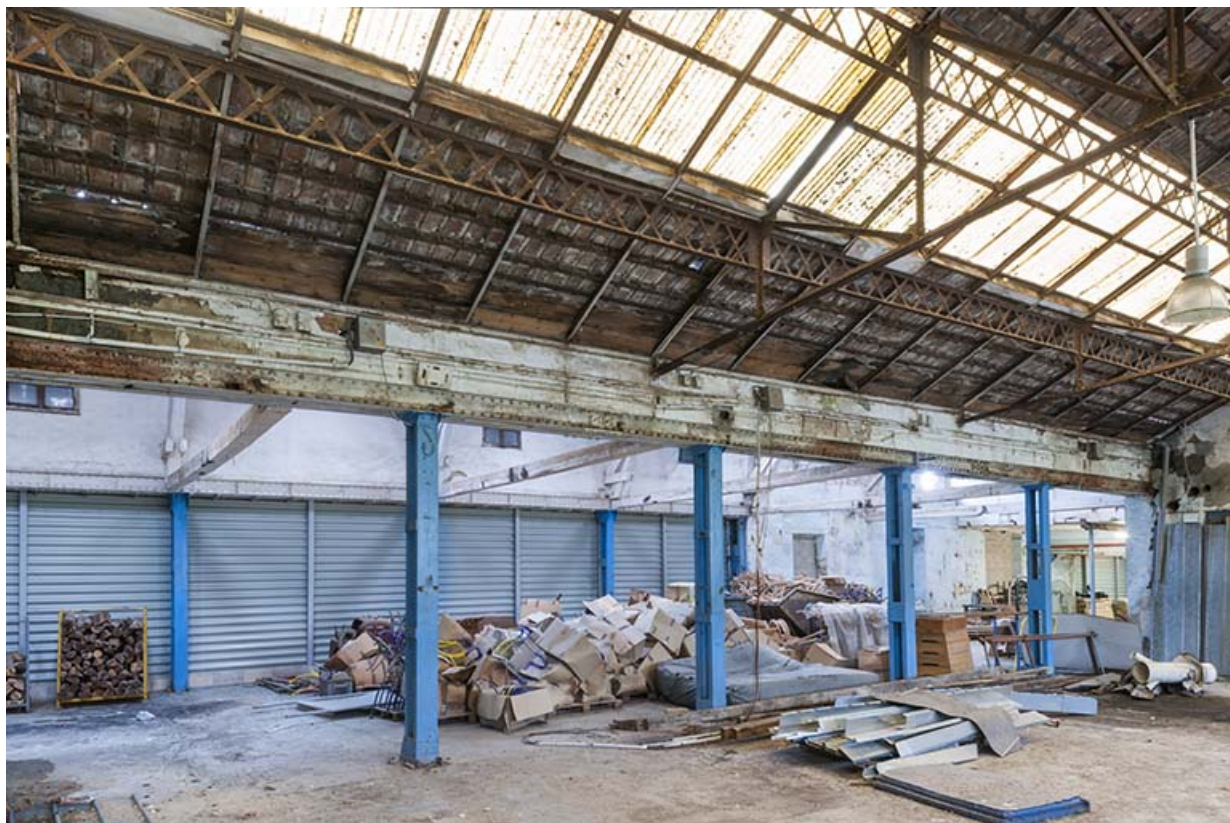
Atelier d'usinage. Vue intérieure de trois quarts.
