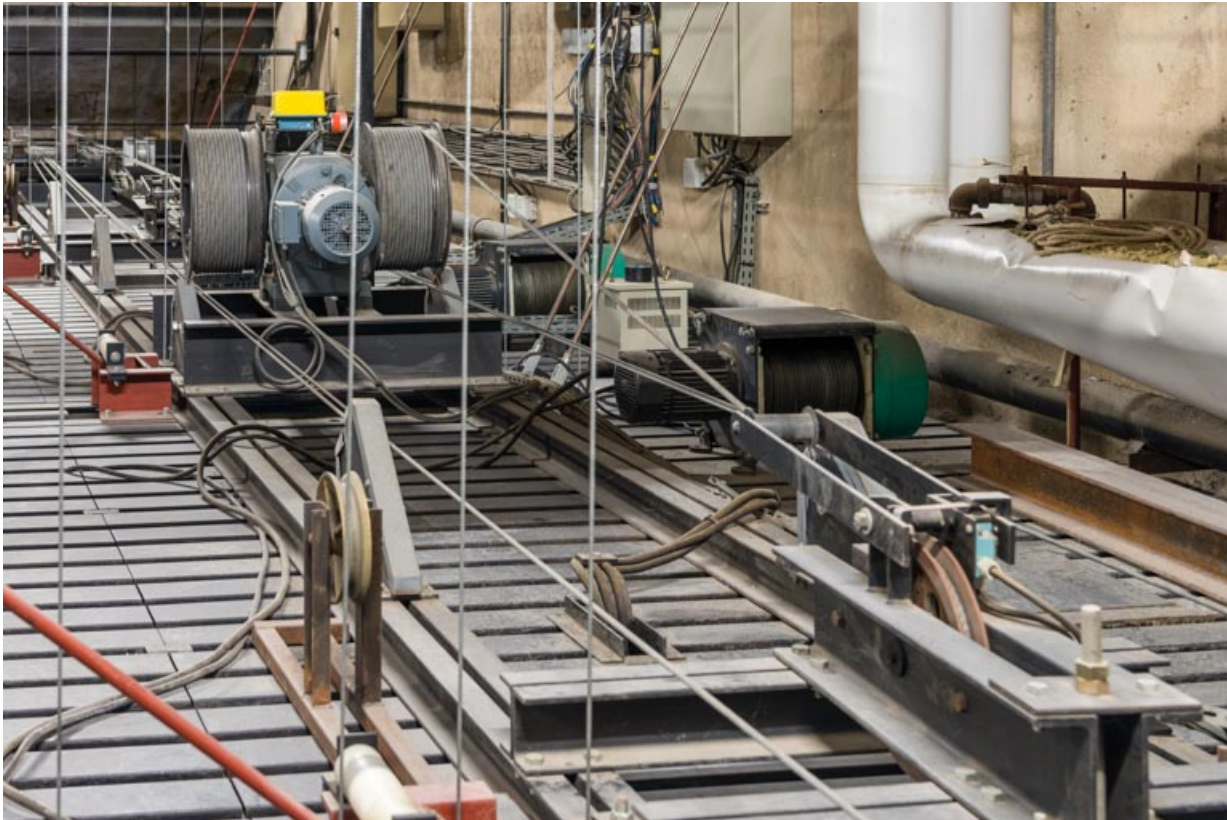
Cintre : moteur électrique d'une équipe (cadrage horizontal).
