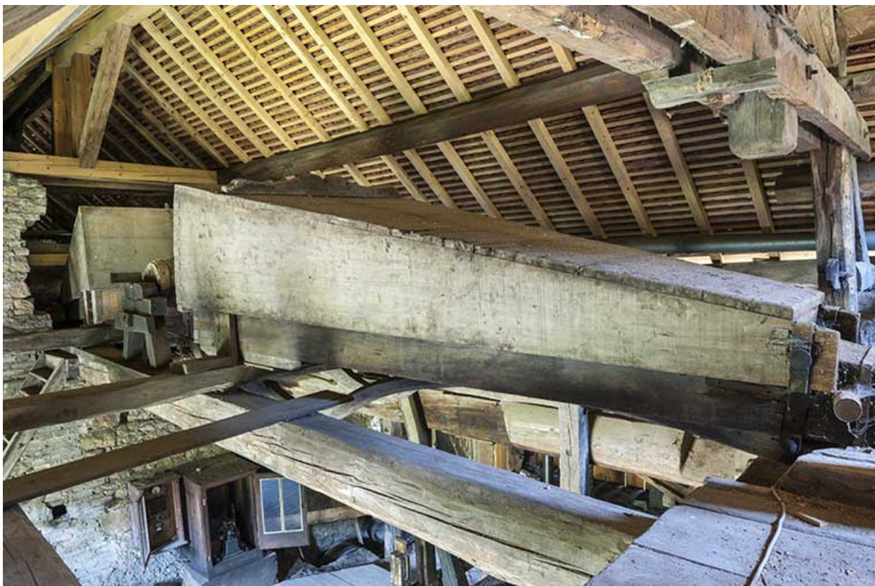
Caissons de la machine soufflante.
