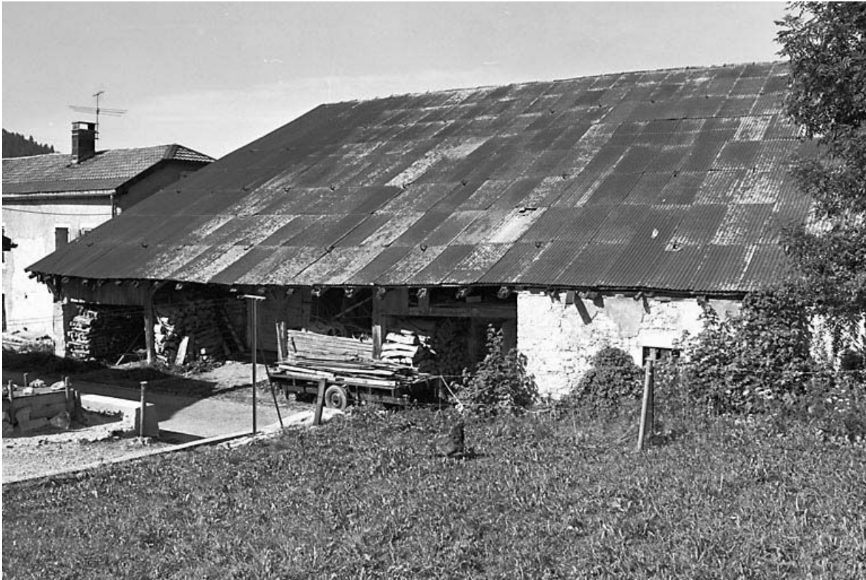
Mur goutterot et toiture.
