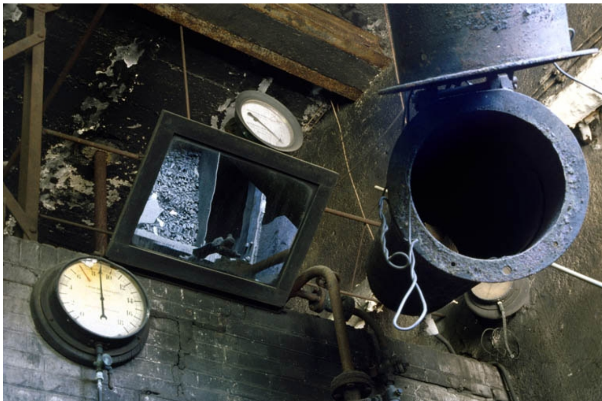
Détail de la partie haute de la chaudière (1927). A droite : tuyau articulé de chargement de la trémie.
