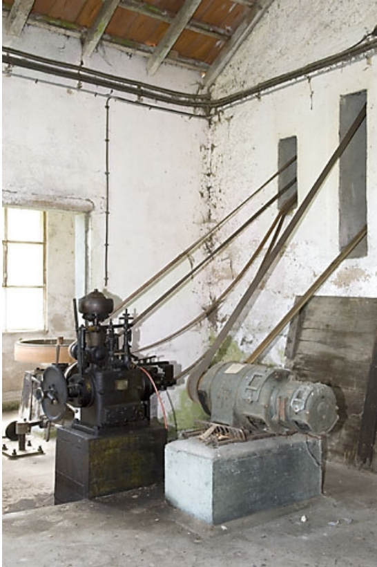
Rez-de-chaussée. Multiplicateur Goulut-Borne (de la turbine) et moteur électrique de la Cie Générale d'Electricité. 70, Fougerolles, lieudit : Fougerolles-le-Château
