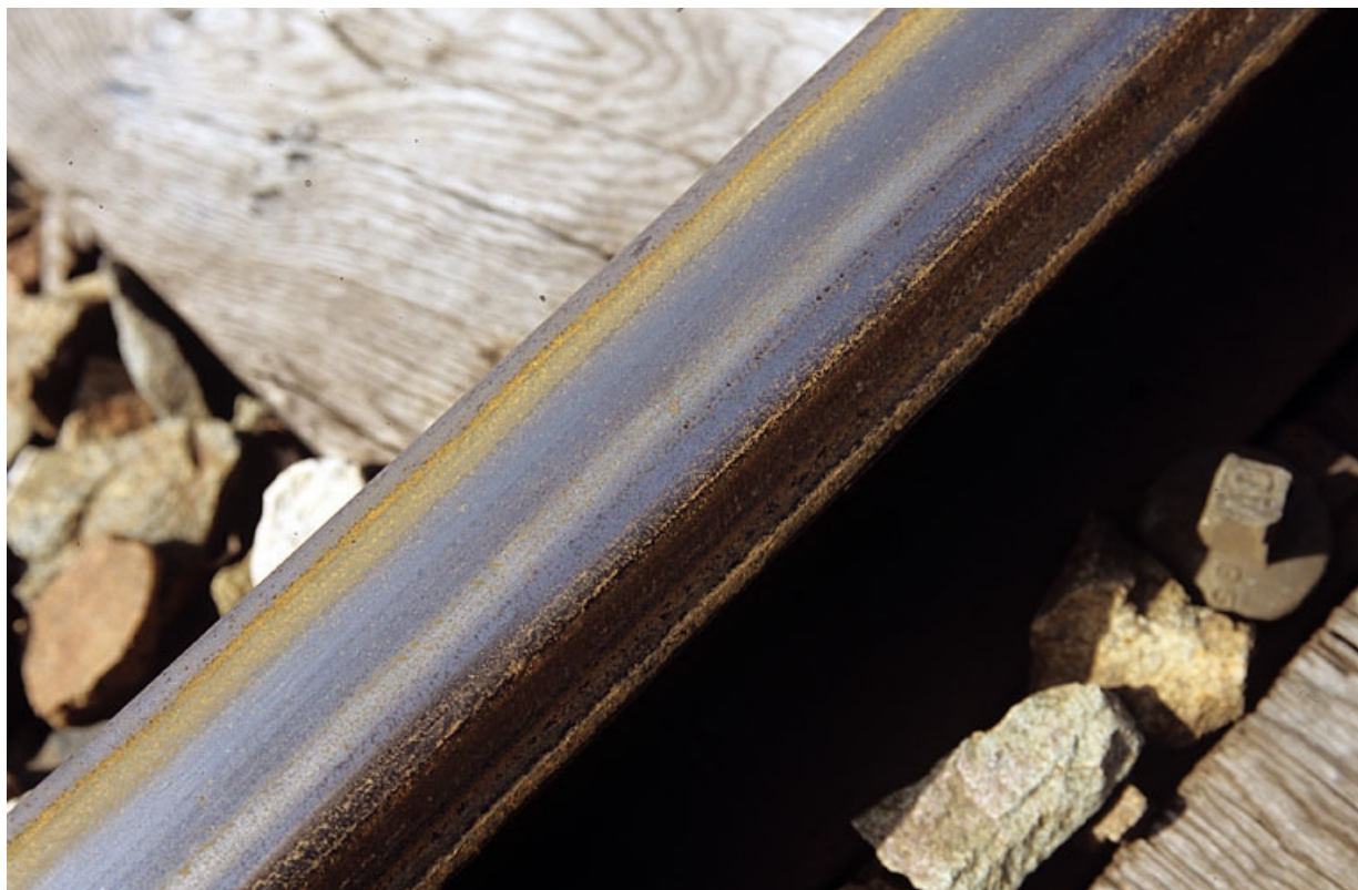
Usure d'un rail, sur le viaduc de Morbier. in, Jura
