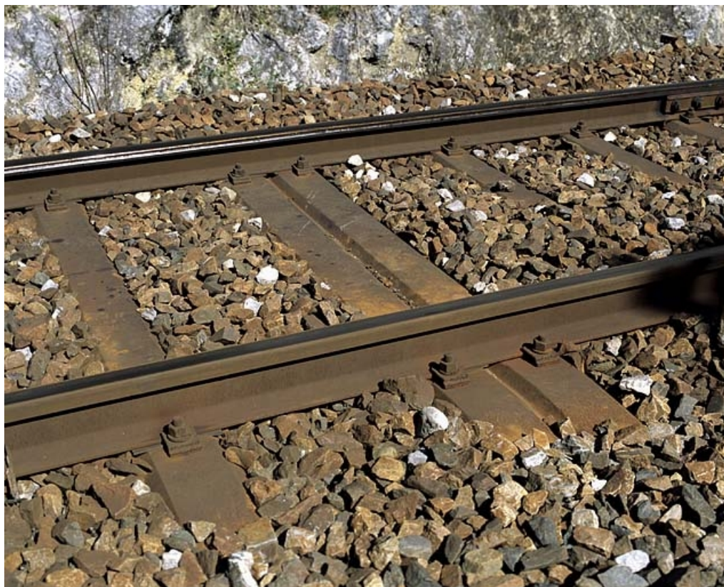
Traverses simples et doubles. Ces traverses sont en place près du point kilométrique 100.200, peu avant le souterrain d'Arbent 1 (commune d'Arbent, Ain).
