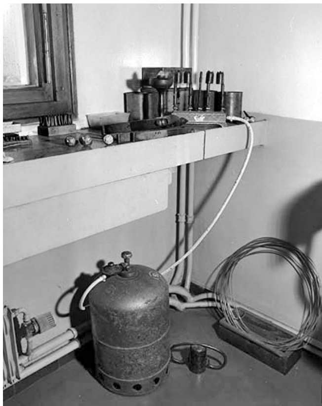
Vue d'ensemble du bec de gaz.
