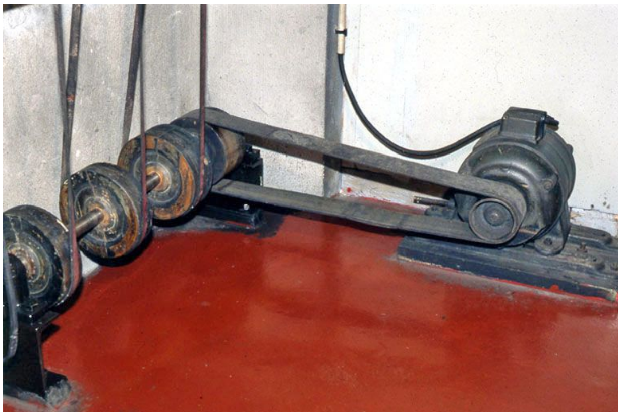
Moteur électrique Roulland et arbre de transmission.
