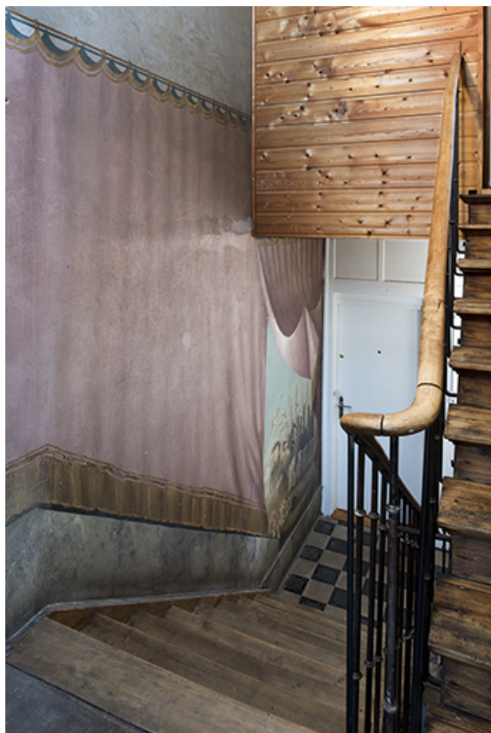
Cage d'escalier depuis le repos entre le 3e et le 4e palier (6e volée). 25, Morteau, 8 rue Gonsalve Pertusier
