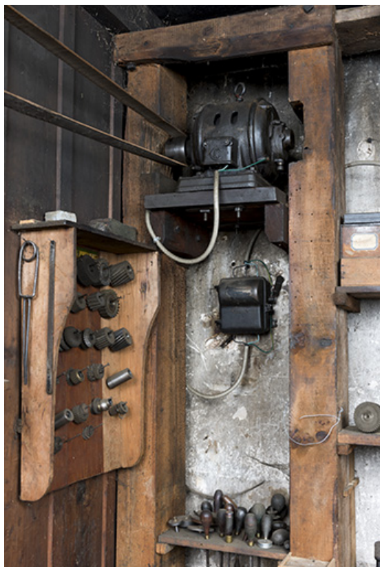
Vue d'ensemble du moteur électrique.
