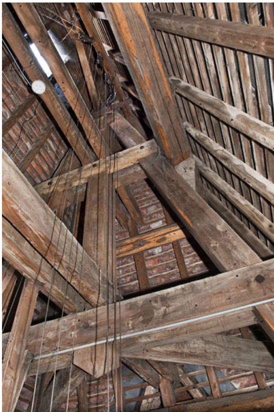
Les filins actionnant les cloches fixées au faitage de la toiture.
