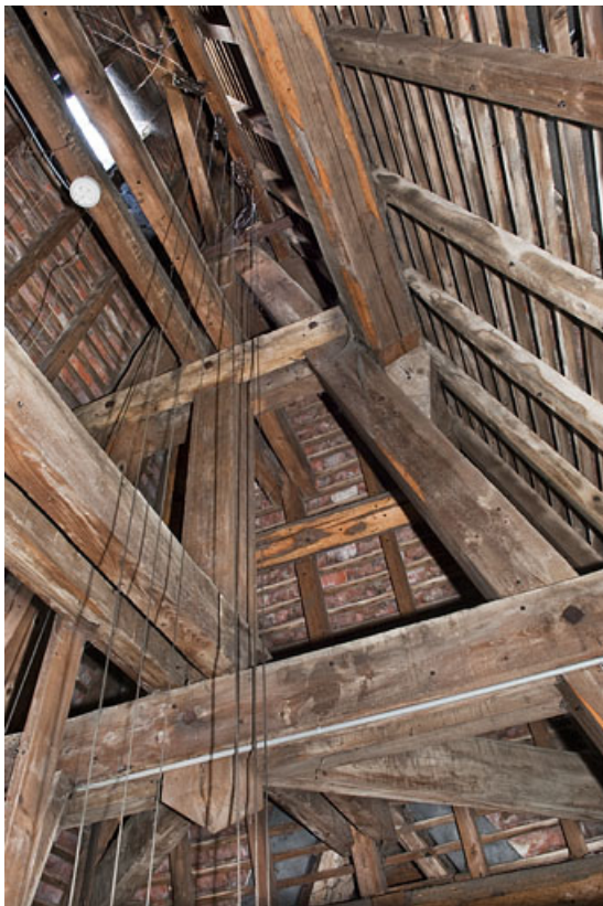
Les filins actionnant les cloches fixées au faîtage de la toiture.
