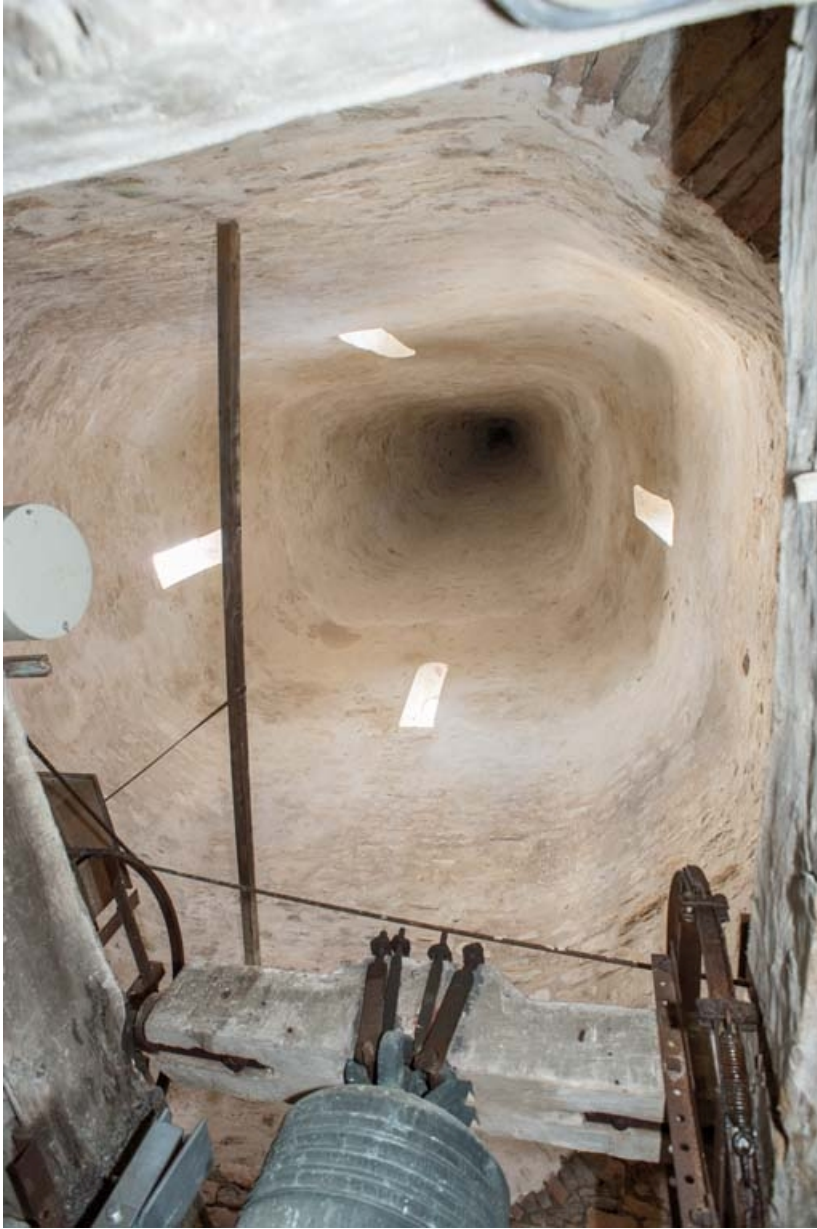
Vue du clocher en tuf depuis le niveau abritant les cloches. 21, Auxey-Duresses
